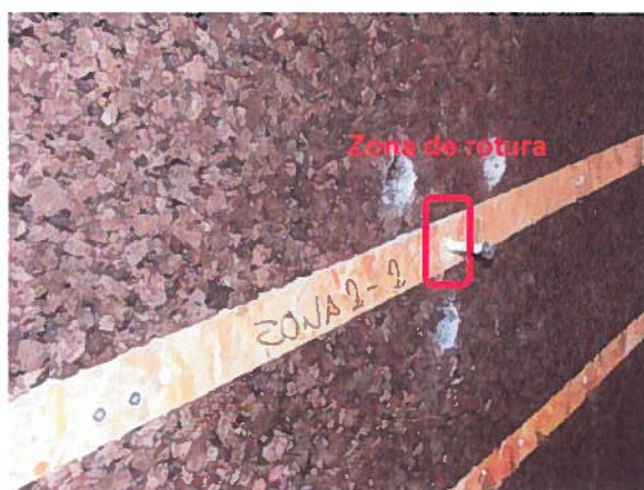
Figura 20. Rotura pelas régua de madeira
